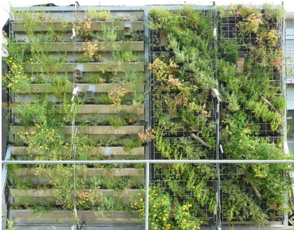
Bild 3: Südfassaden an der KFS, links zehn Rinnen und rechts zehn Gabionen (Juni 2021).
