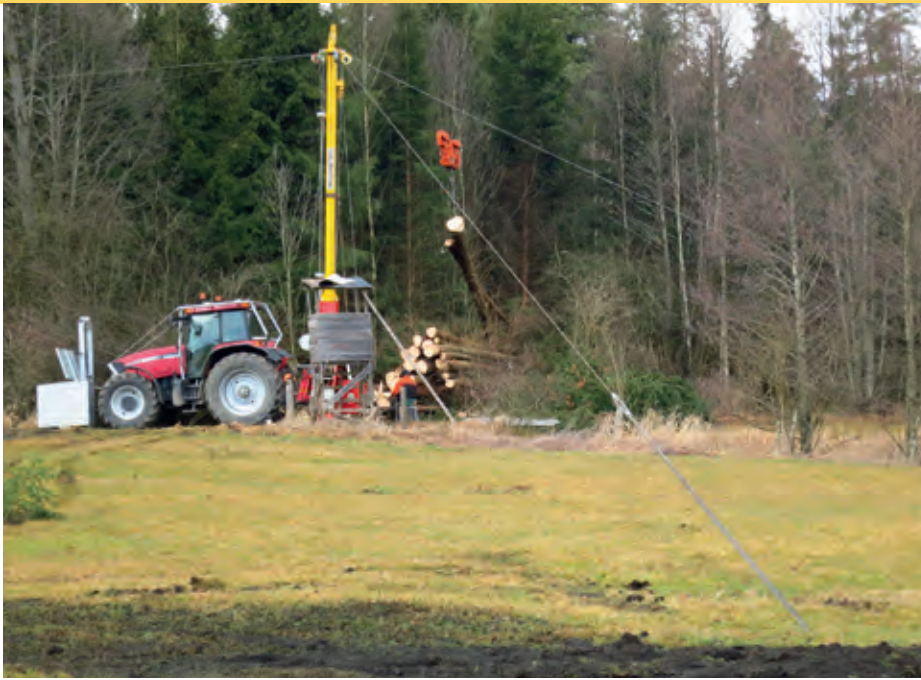
1 Der Schlepper mit Seilkranmast beim Rücken der Vollbäume; im Vordergrund rechts verschwindet ein Abspannseil im Boden – darunter befindet sich der Erdanker bzw. »Totmann«. Foto: R. Wende
