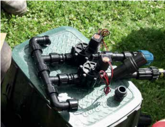
Bild 5: Verteilung zu den Beregnungskreisen. Montage vor dem Einsetzen in einen ausreichend großen Ventilkasten.
