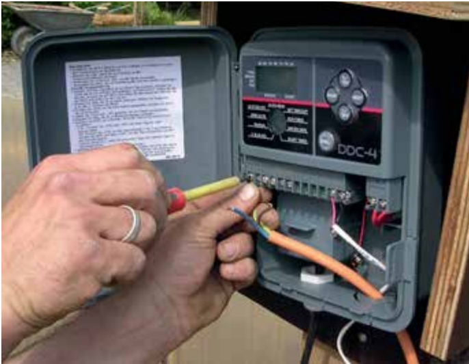
Bild 2: Hier wäre ein Elektriker erforderlich.
